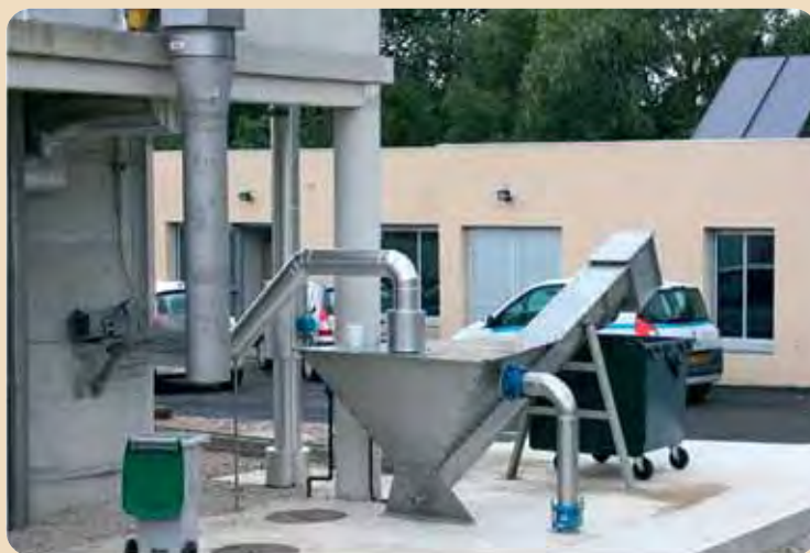
Station d'épuration de PRESLES (95)
